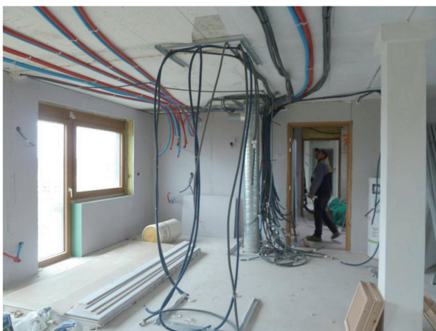
Passage des câbles en sous-plafond © Patrice Lutier
