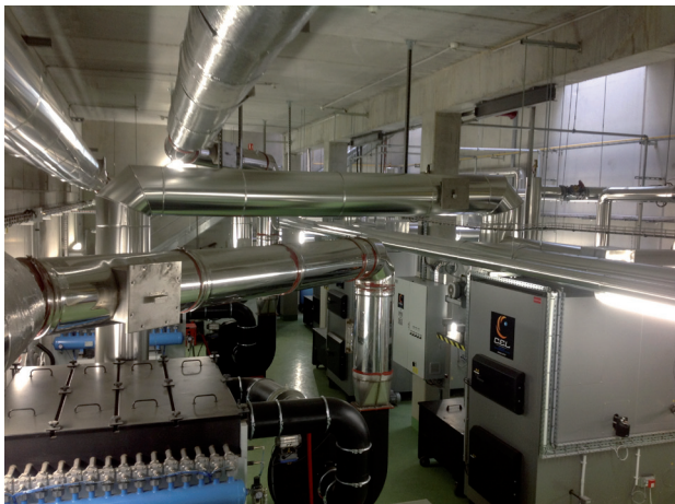
Vue de la chaufferie © Ekopolis
