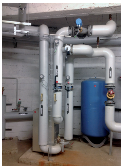
Sous station © Ekopolis
